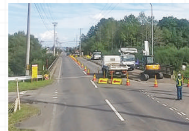
北1線橋 交通量が多い道路での交通規制。安全対策をしっかり行いました
