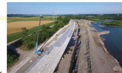
▲ 施工中の様子（祥栄橋上流地区） 鮮やかな十勝の大自然に白いブロックが映えて美しい光景が広がっています
