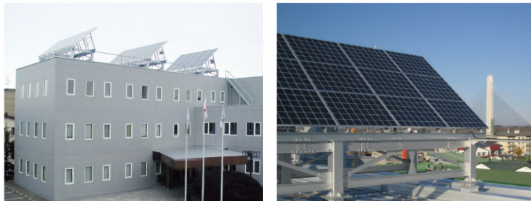
▲ 平成 17 年に設置した本社の太陽光発電パネル。年間でおおよそ 13,823.2kWh を発電しています（令和 3 年度実績）
