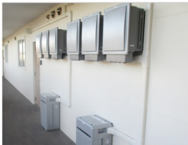
▲ 今回の工事で、社宅の廊下に新設した蓄電池
