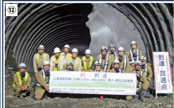
⑫ 令和7年6月、札幌側貫通の際の記念写真。右側を残し左半分が貫通している（職員の後ろの壁部分）
