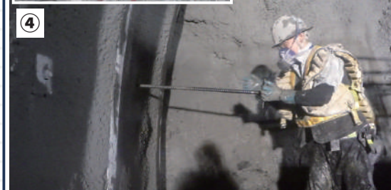
④ ロックボルト打ち込みの様子。トンネル内部から放射状にロックボルトを打ち込み、地山と一体化させる。
